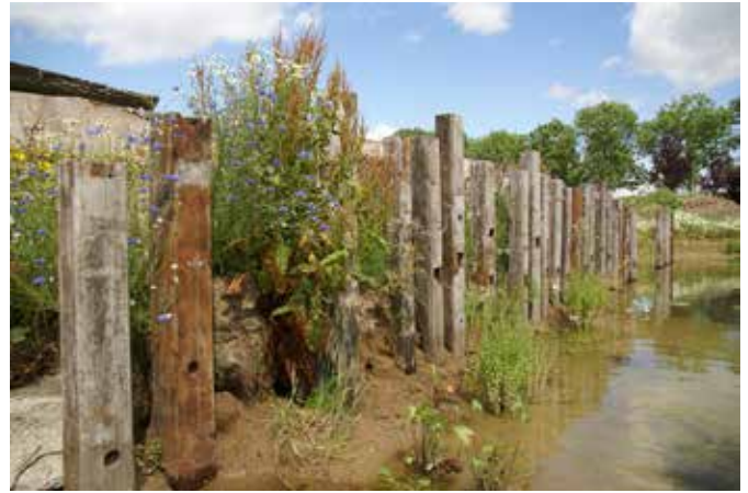
Oeverversterking door onregelmatig geplaatste, hergebruikte, balken
